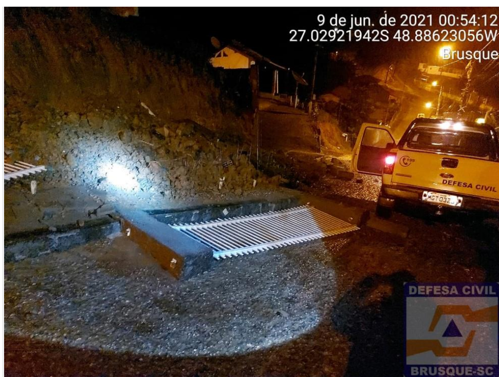
Muros e portões foram derrubados com a chuva no início da madrugada em Brusque — Foto: Defesa Civil/ Divulgação
