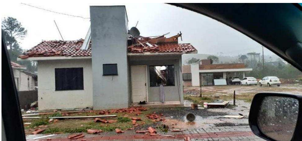
Destelhamento em Água Doce após temporal — Foto: Reprodução/Defesa Civil
