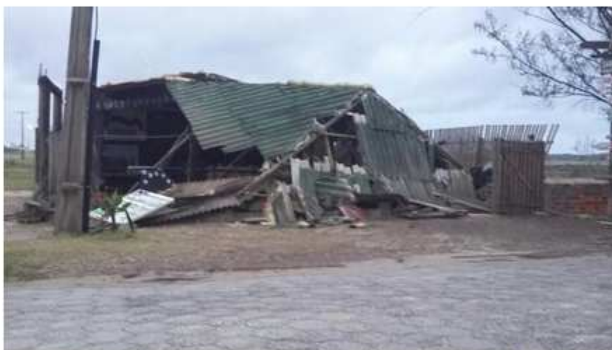
Em Balneário Rincão, telhados de casas ficaram danificados em função dos fortes ventos. Foto: Defesa Civil
