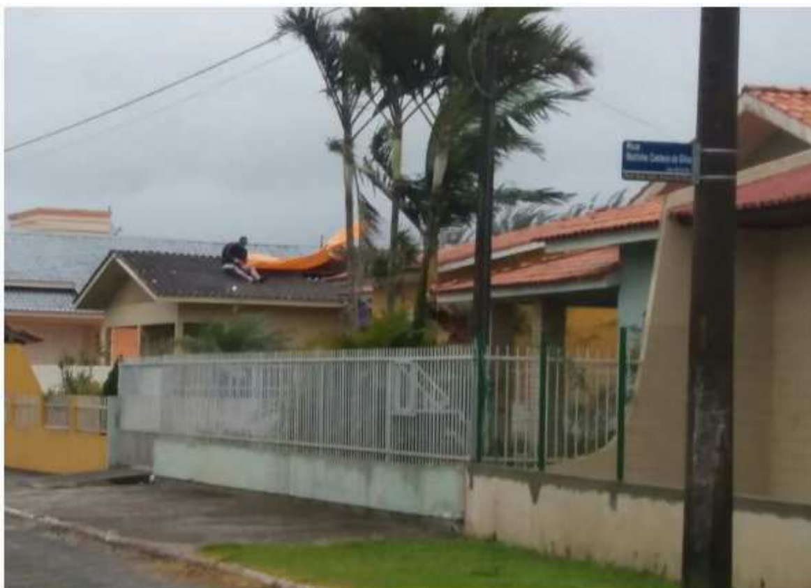
Defesa Civil distribuiu lonas a moradores que tiveram casas destelhadas - Balneário Arroio da Silva/Defesa Civil Municipal
