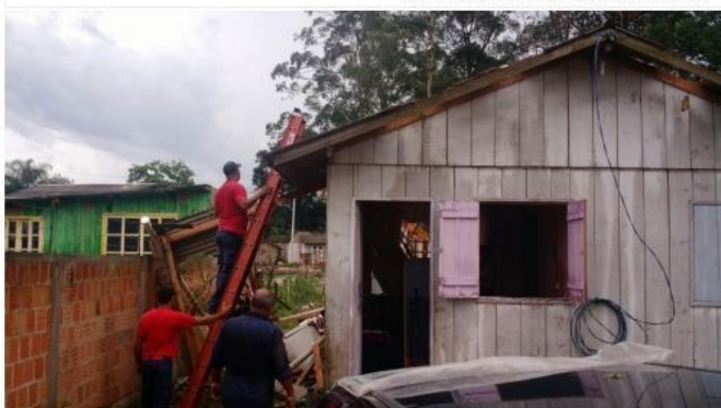
Casa foi destelhada no bairro Frei Damião
