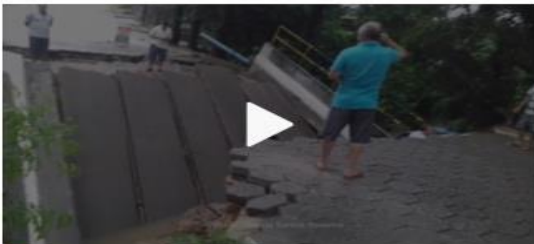
Portão que dá acesso à Ilhota, em Florianópolis, desaba por causa da chuva
