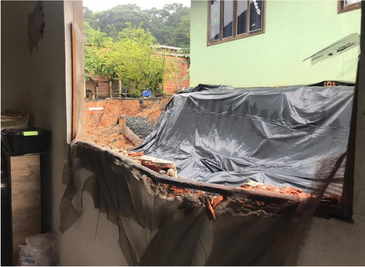
Desabamento no bairro Paranaguamirim, em Joinville — Foto: Kleber Pizzamiglio/ NSC TV
